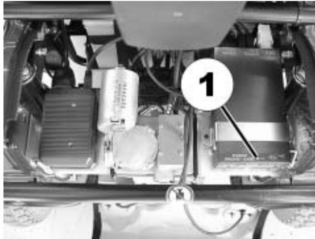
Statusanzeige des Servo-Licht-Moduls (hintere Verkleidung entfernt)
